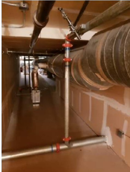
Utilidor Dry Sprinkler Pipe
